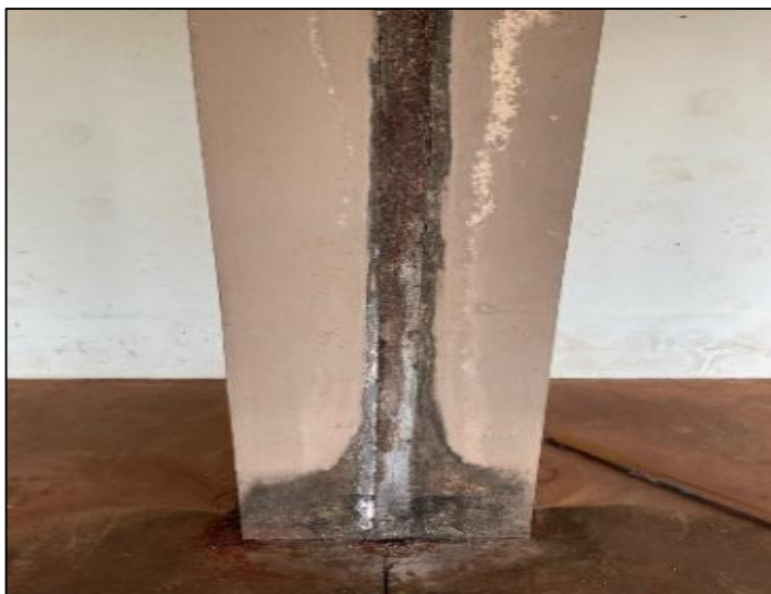
Figura 3: Umidade em pilar no setor leste do estádio.
