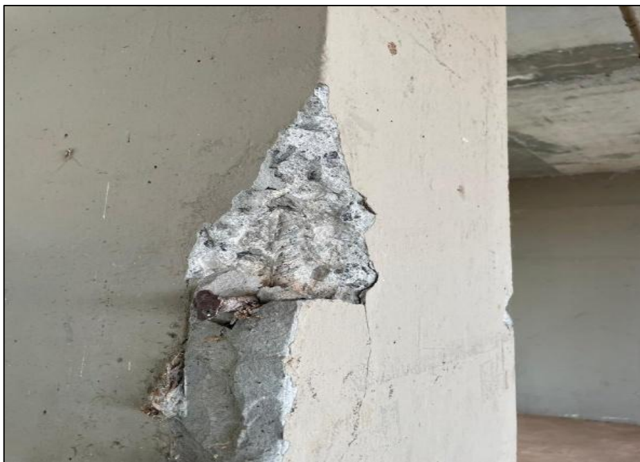
Figura 5: Desagregação do Concreto no setor leste -Estádio Mirandão -Araguaína -To.
