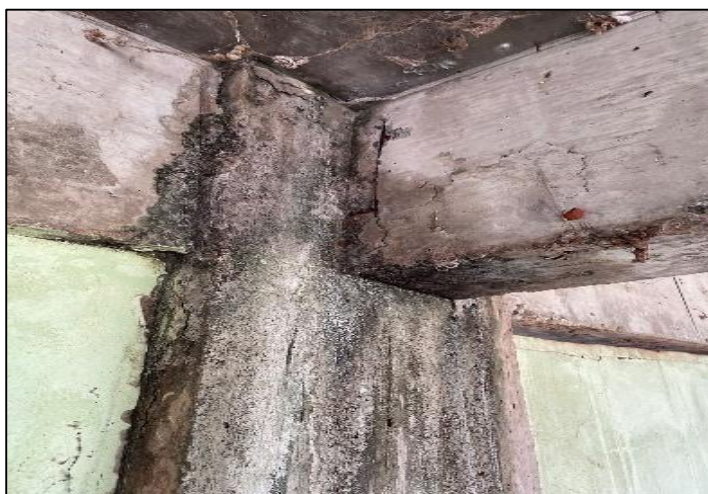
Figura 4: Umidade em viga e pilar no setor leste.
