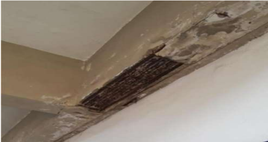
Figura 5: Desagregação do Concreto.
