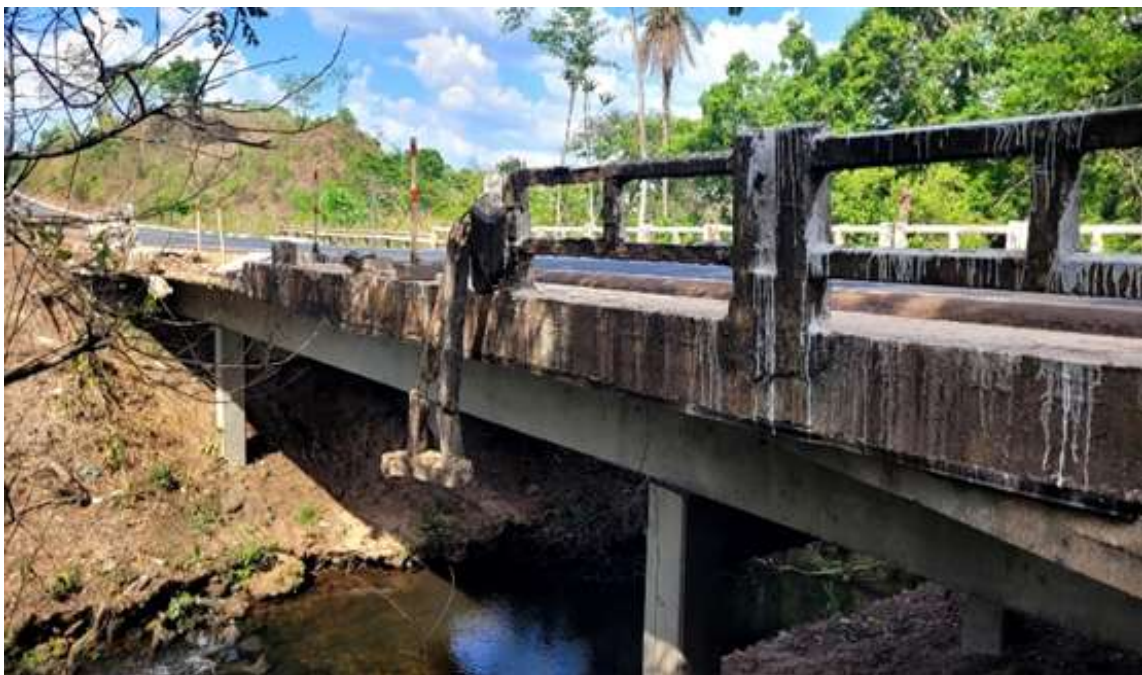
Figura 11: BR-153; Lixiviação - Ponte Rio Bandeira.
