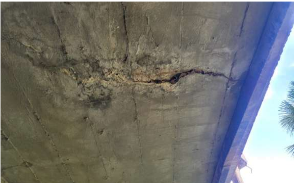
Figura 10: Destacamento de cobrimento - Ponte Ribeirão Brejão.
