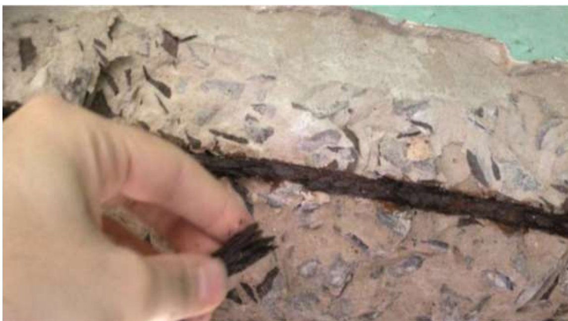
Figura 2: Corrosão das Armaduras.
