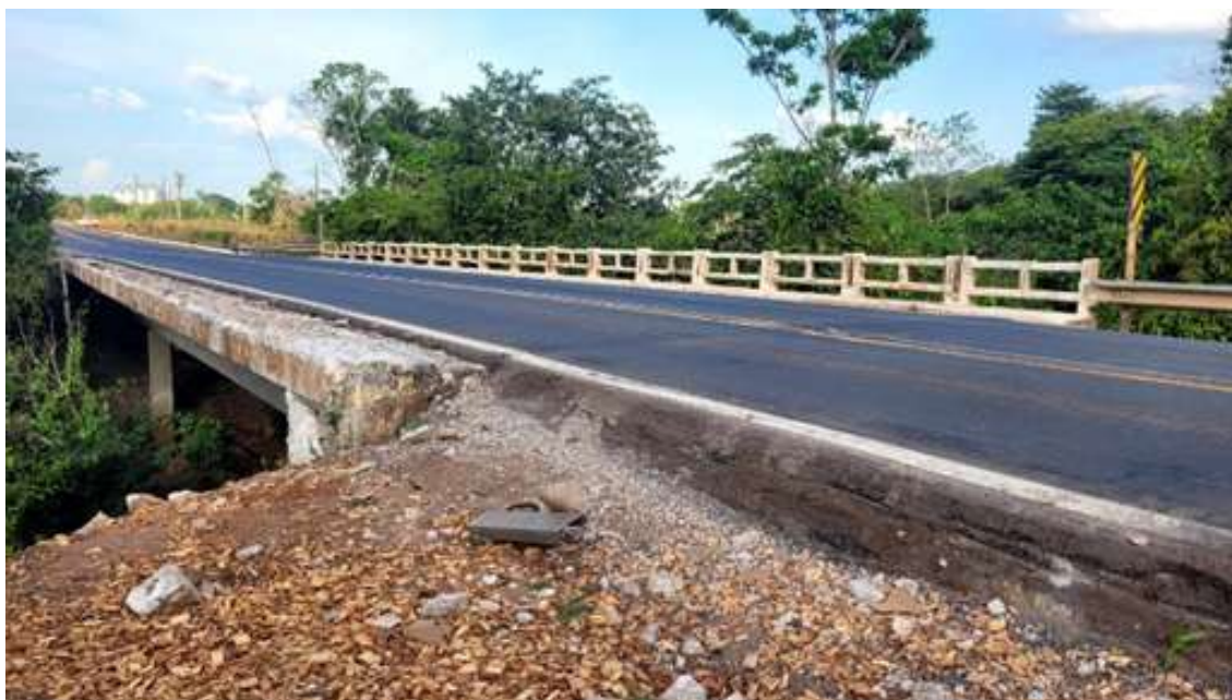
Figura 14: Falta de drenagem - Ponte Rio Bandeira.
