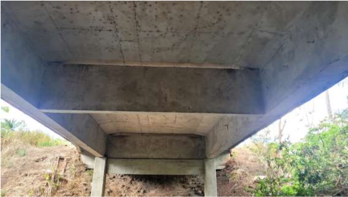
Figura 12: BR-153; Eflorescência - Ponte Rio Bandeira.
