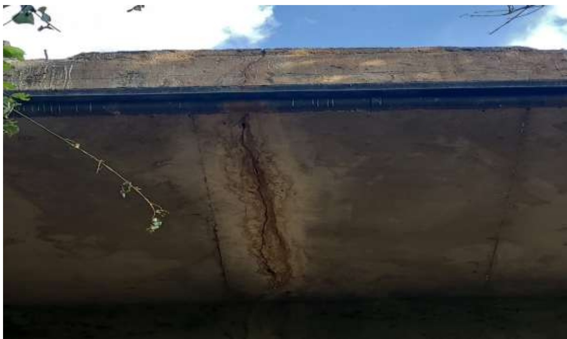
Figura 13: Fissuração longitudinal - Ponte Rio Pontes.
