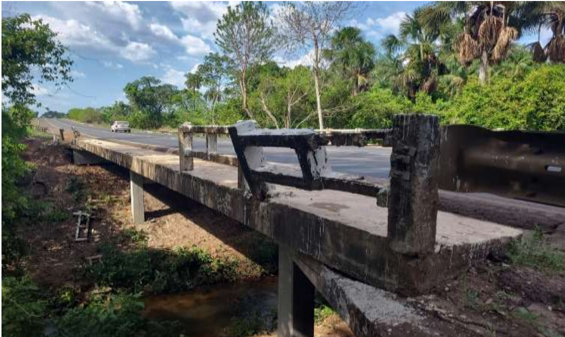
Figura 9: Corrosão de armaduras - Ponte Ribeirão Brejão.
